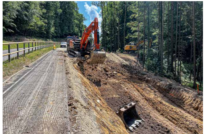
Bild 2: Böschungsrutsch; Kreisstraße BA 16 bei Zückshut
