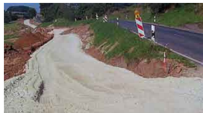
BA 37 westlich von Priegendorf mit Umbau der Einmündung GVS Krappenhof: Baulänge Geh- und Radweg 930 m veranschlagte Gesamtkosten 435.000 € GVFG-Zuwendung 220.000 €
