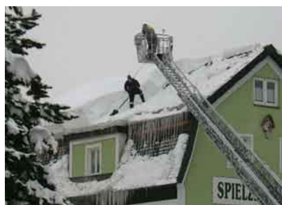
Viele Dächer drohten unter der Schneelast einzubrechen – kein ungefährlicher Einsatz für die zahlreichen Helfer, die aus ganz Bayern angereist waren.
