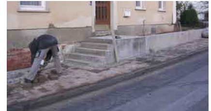
Ortsdurchfahrt Stappenbach (BA 29): Entlang der gesamten Hauptstraße sorgen neue Gehwege für mehr Sicherheit.
